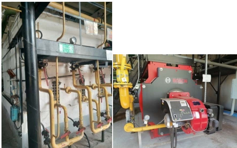
Рис. 2. Внешний вид котла до и после автоматизации (котельная «Июльская, 38»)
