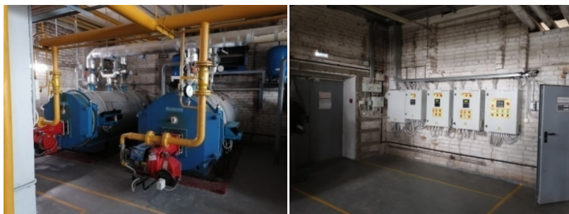
Рис. 3. Внешний вид автоматической котельной «Ялтинская, 55а»
